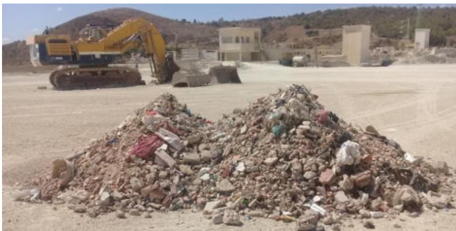
Figure 23: Déchets de chantiers du site 1 de Mnihla avant l'opération de tri
