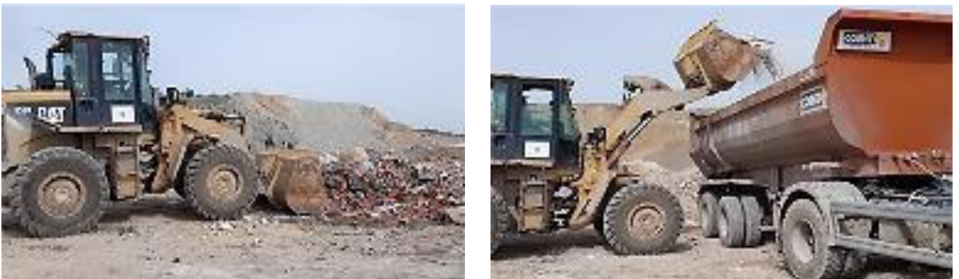
Figure 10 : Enlèvement de 45 m 3 de déchets dans une décharge autorisée « CAT » à El Ouradia puis transport à une carrière à l'Ariana
